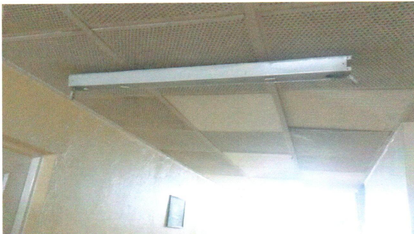
Fot. 4. Stan sufitu i osłon oświetlenia w/w budynku.
