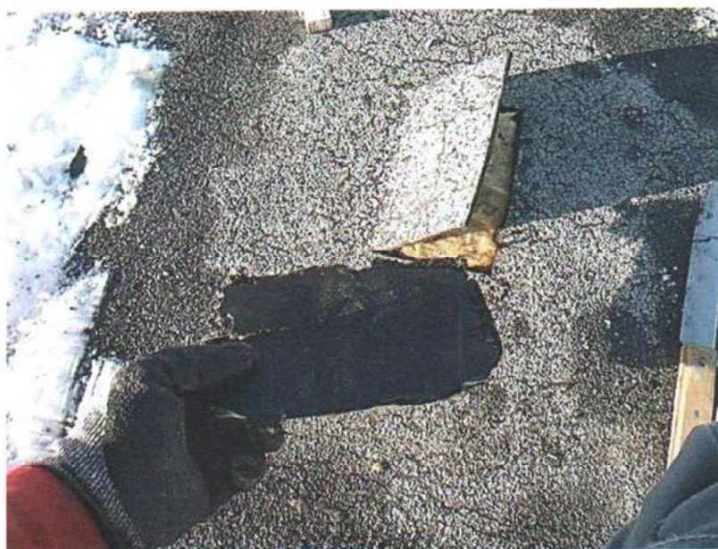
Fot.5 Papa podkładowa dachu wyższej części budynku nie wykazuje żadnej elastyczności w warunkach niezbyt niskich temperatur ( < -3^{\circ}\text{C} )
