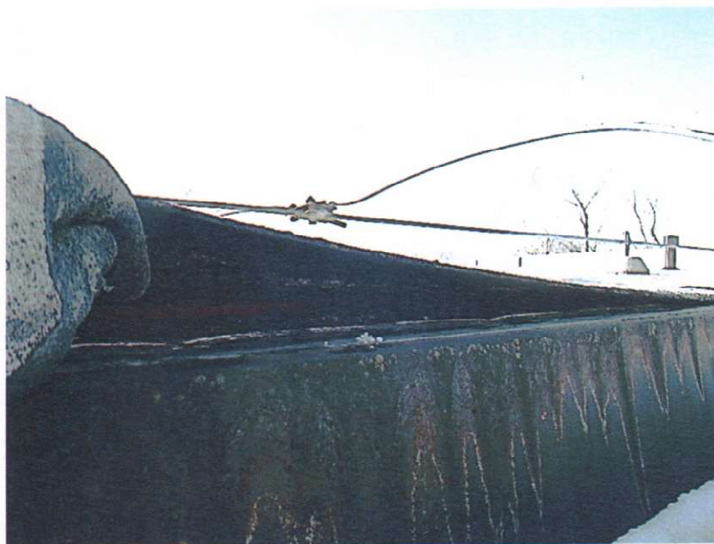
Fot.6 Brak zgrzania papy do pasa nadrynnowego wzdłuż północnej krawędzi dachu wyższej części budynku
