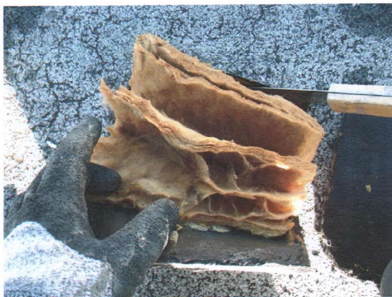
Fot.7 Degradacja ocieplenia dachu wyższej części budynku na skutek permanentnego zamaczania
