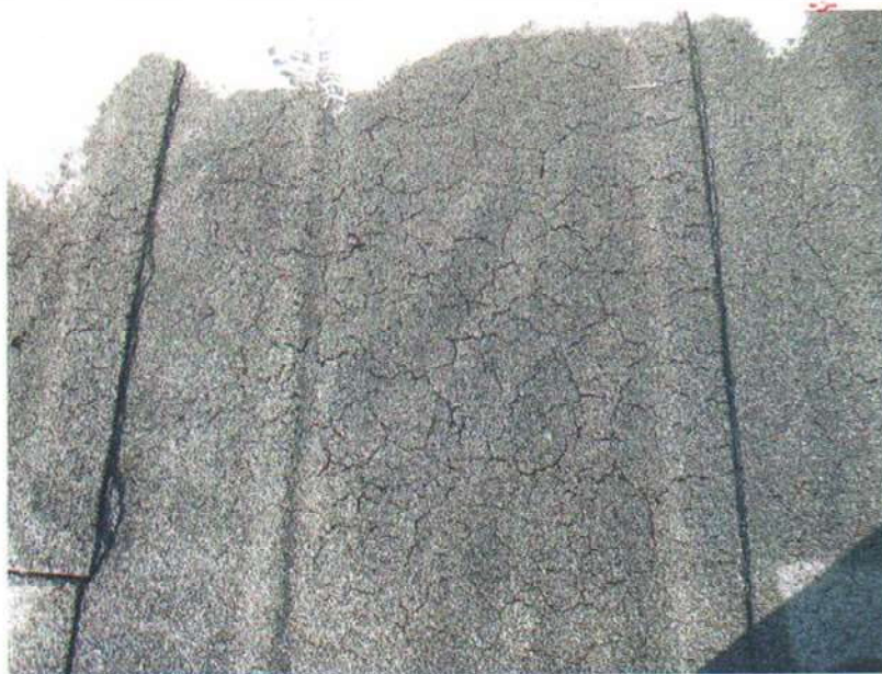
Fot.4 Spękania papy termozgrzewalnej wierzchniego krycia na dachu wyższej części budynku
