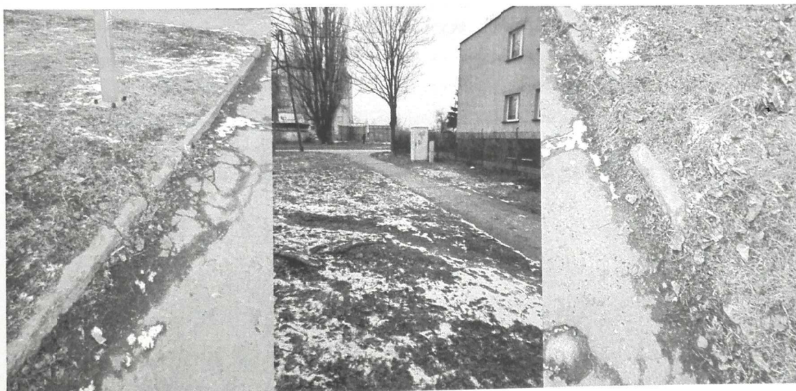
Rysunek 3. Widok na zniszczone obrzeża i chodnik betonowy.
