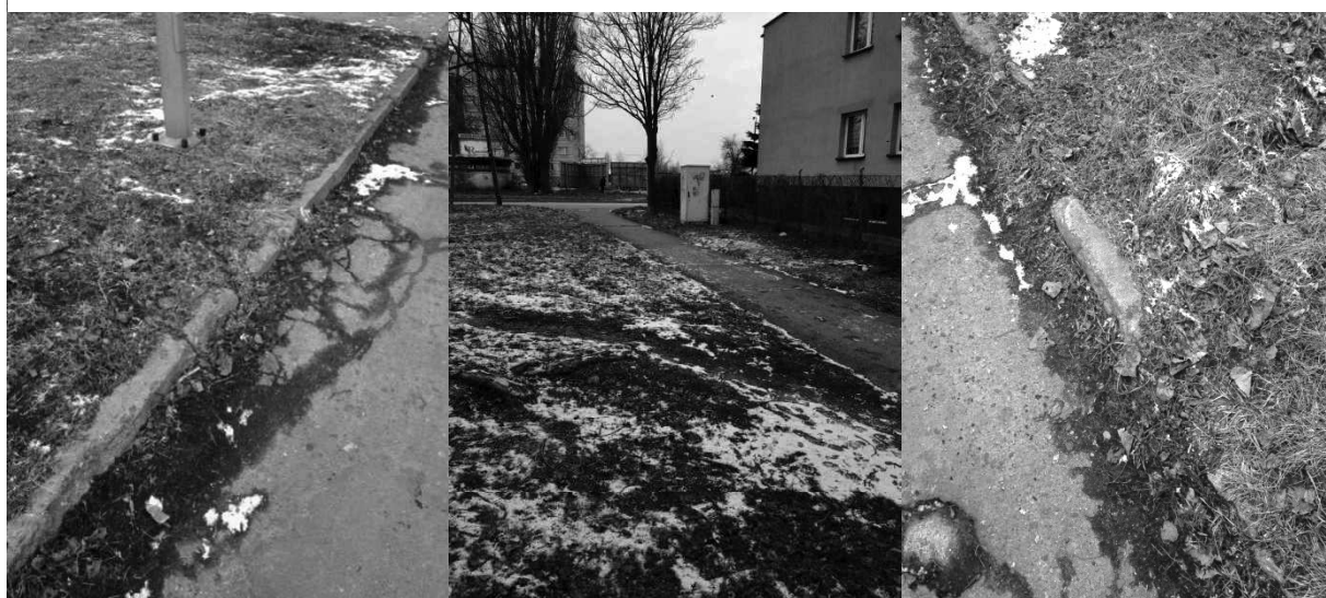
Rysunek 3. Widok na zniszczone obrzeża i chodnik betonowy.
