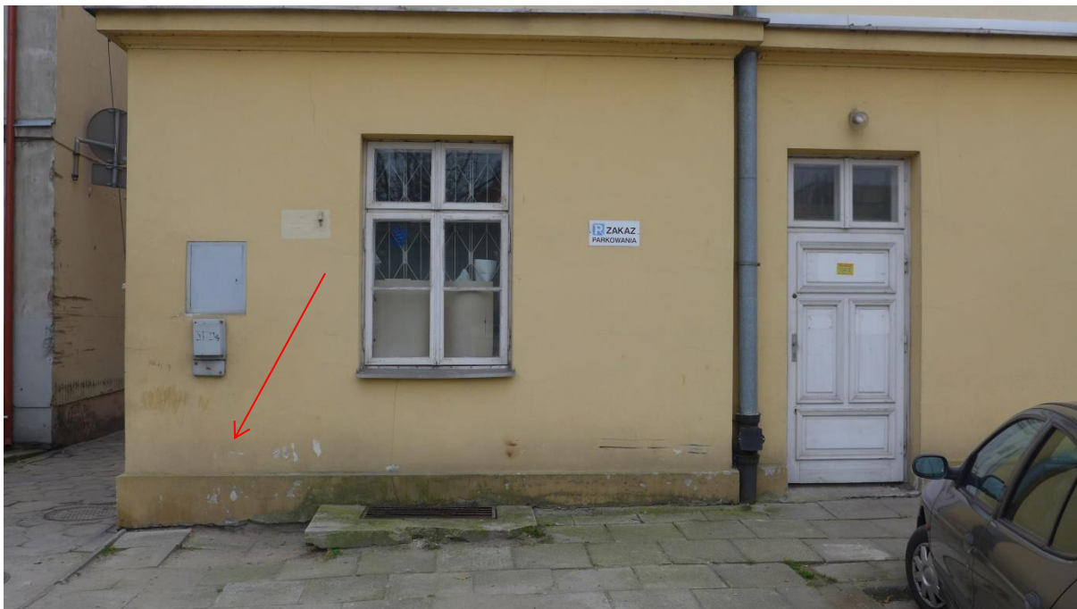
Fot.10 Zawilgocenie (czerwona strzałka) narożnika północno-wschodniego budynku; zapadliska płyt chodnikowych w pobliżu budynku.
