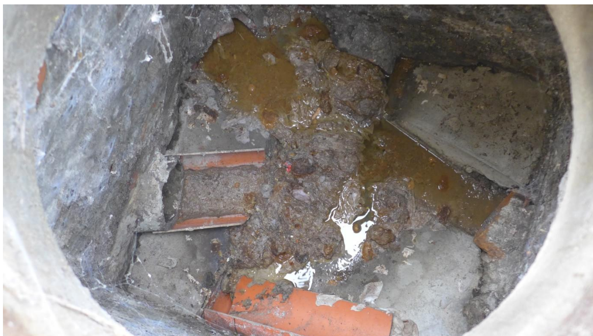
Fot.7 Studnia kanalizacyjna z widoczną niedrożną rurą kanalizacyjną
