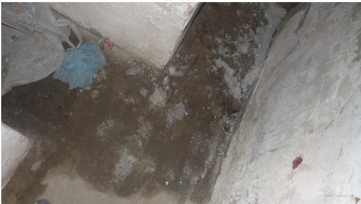
Fot.5. Zawilgocenie posadzki w piwnicy spowodowane wylewaniem się wody z kanału c.o. od strony północnej
