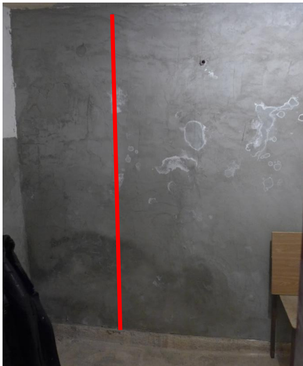
Fot.13 Wykwity solne na ścianie zachodniej w piwnicy; usytuowanie pionu 7. Silne zawilgocenie w dolnej partii ściany
