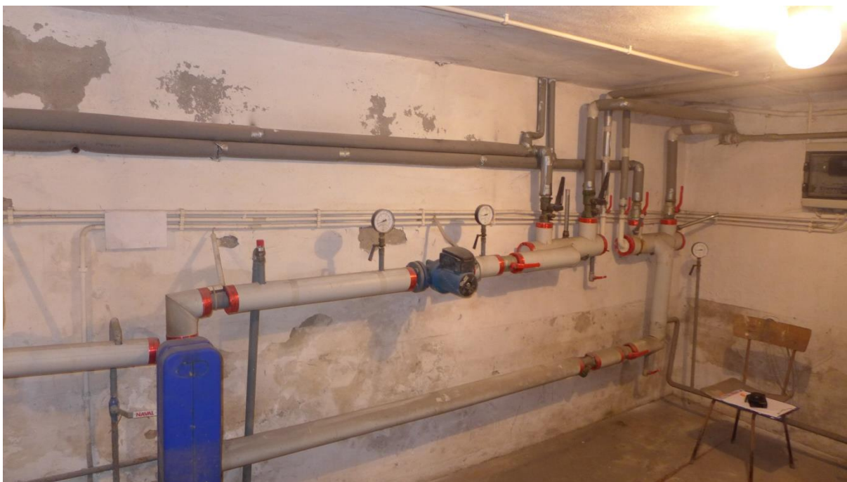
Fot.4 Widok korozji powierzchniowej ścian piwnicy w narożniku południowo-wschodnim
