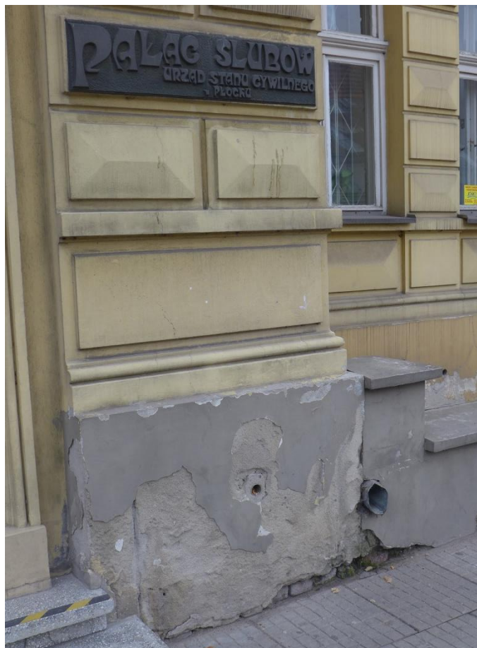
Fot.8. Korozja tynku cokołowego w pobliżu wejścia do budynku od strony południowej
