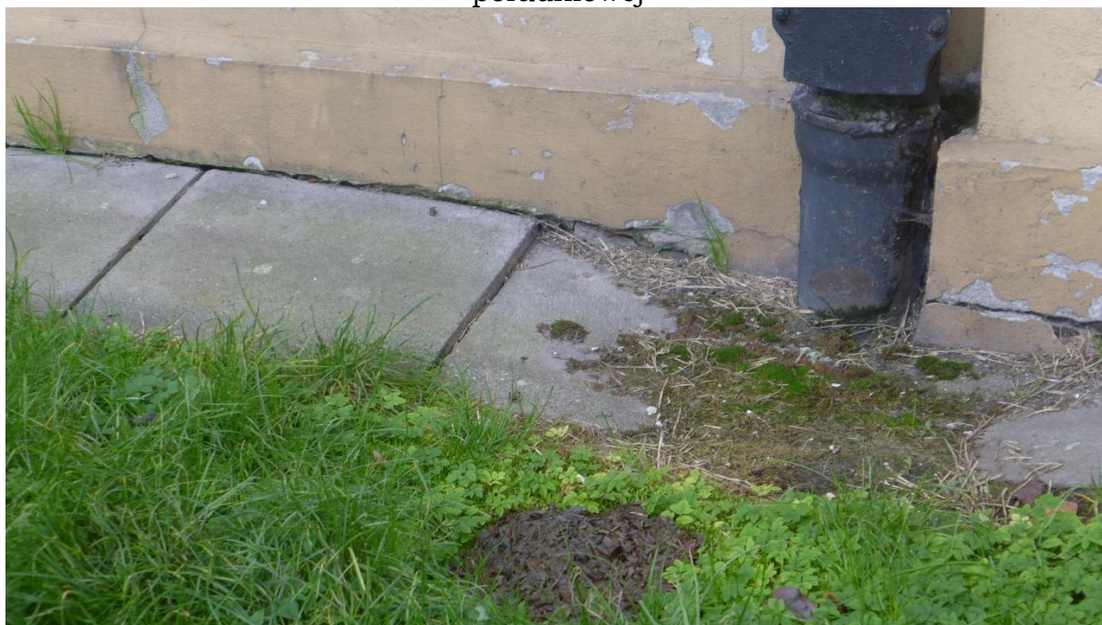
Fot.9 Zapadlisko terenu w pobliżu rury spustowej od strony północno-wschodniej
