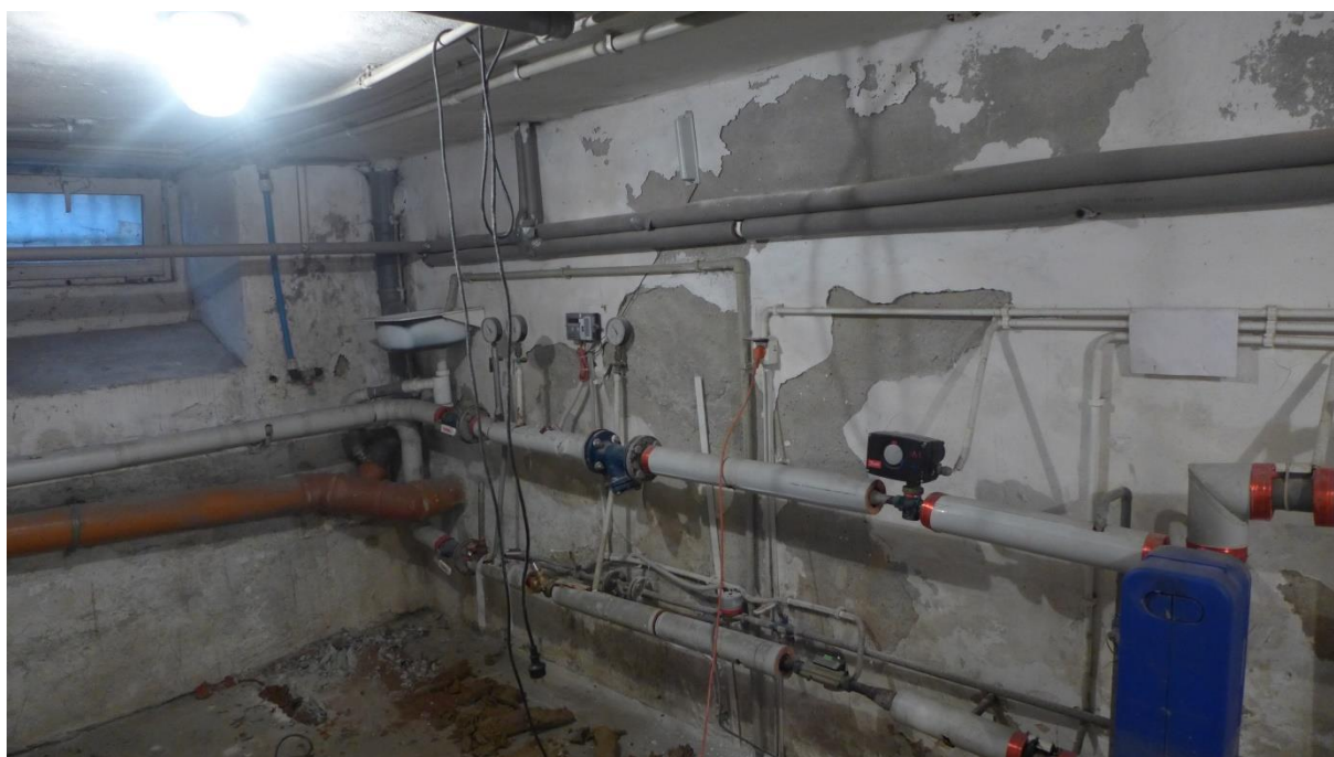
Fot.3. Widok korozji powierzchniowej ścian piwnicy w narożniku północno-wschodnim
