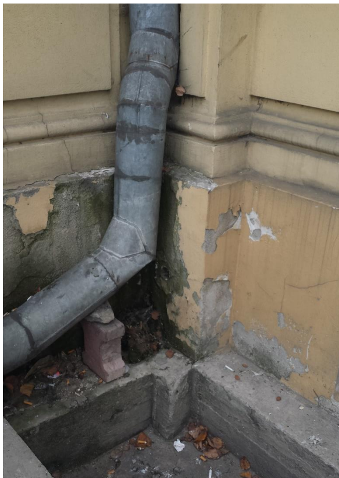
Fot.1. Zawilgocona partia ściany cokołowej w pobliżu rynny od strony południowej. Miejsce przedostawania się wód opadowych w nieszczelnej rury spustowej do wnętrza budynku.
